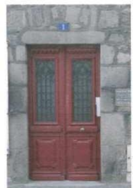
Le mur aurait dû être enduit autour du cadre de la porte
