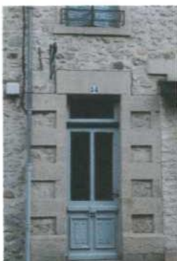
Cet encadrement de porte ne convient pas au mur de pierres apparentes
